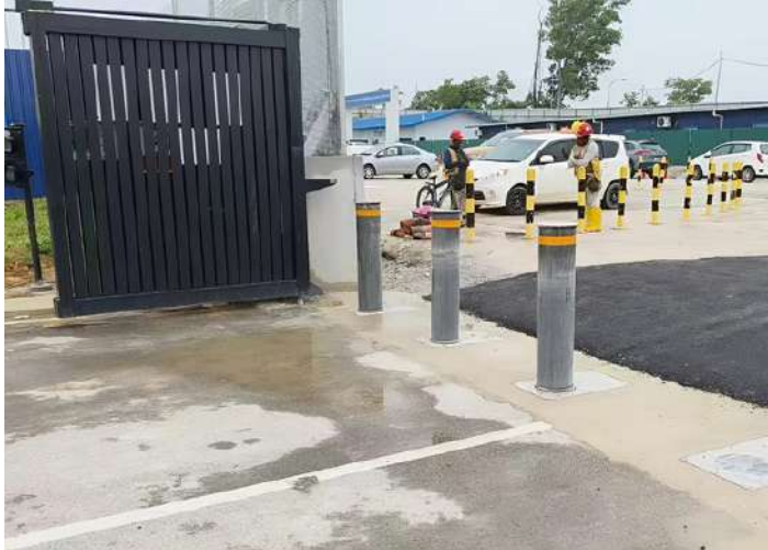
Hệ thống kiểm soát an ninh lắp đặt tại Cục cảnh sát phòng chống tội phạm ma túy - Bộ Công An
