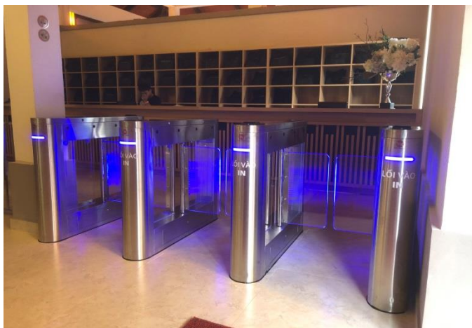
Khu du lịch suối nước nóng Bang – Quảng Bình Hệ thống kiểm soát Khách du lịch
