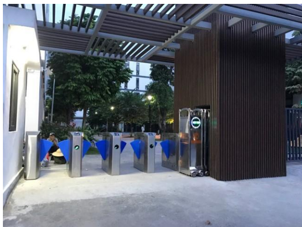
Hệ thống kiểm soát Học sinh tại Trường Quốc tế Gateway - Hà Nội
