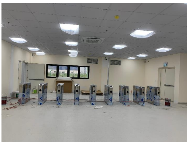
Hệ thống kiểm soát Nhân viên tại Nhà máy công nghệ Welco Việt Nam
