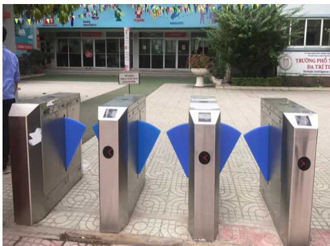
Hệ thống kiểm soát Học sinh tại Trường PT liên cấp M.I.S - Hà Nội
