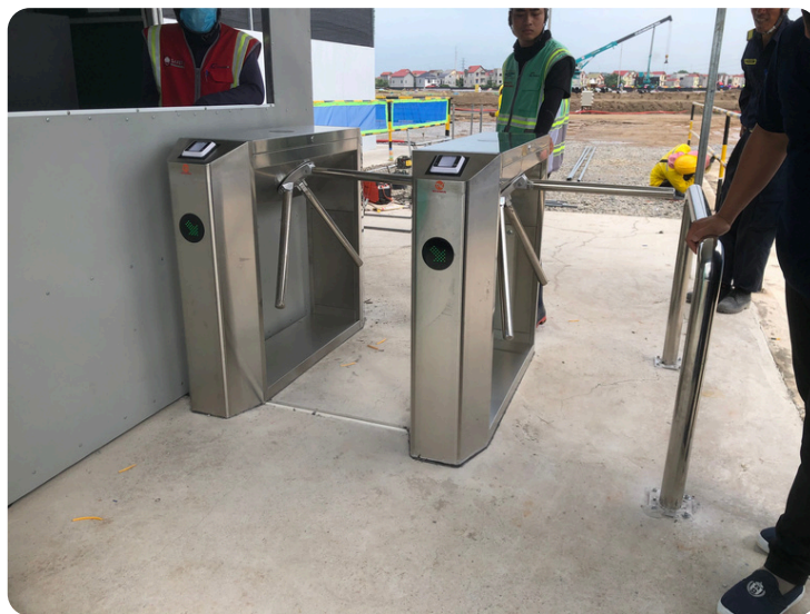
Hệ thống kiểm soát vào ra công trường Công trường Cotecons Bắc Ninh
