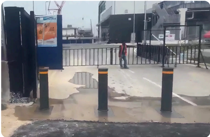
Hệ thống kiểm soát an ninh lắp đặt tại Khu công nghiệp Vsip Hải Dương
