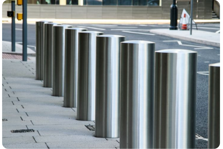
Hệ thống kiểm soát an ninh lắp đặt tại lối ra vào tòa nhà Ngân hàng Viettinbank
