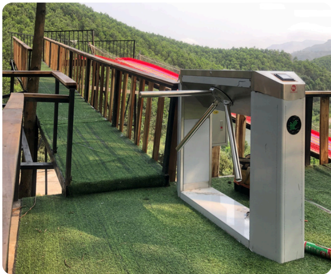
Hệ thống kiểm soát vé ra vào Khu du lịch sinh thái Khe Chè
