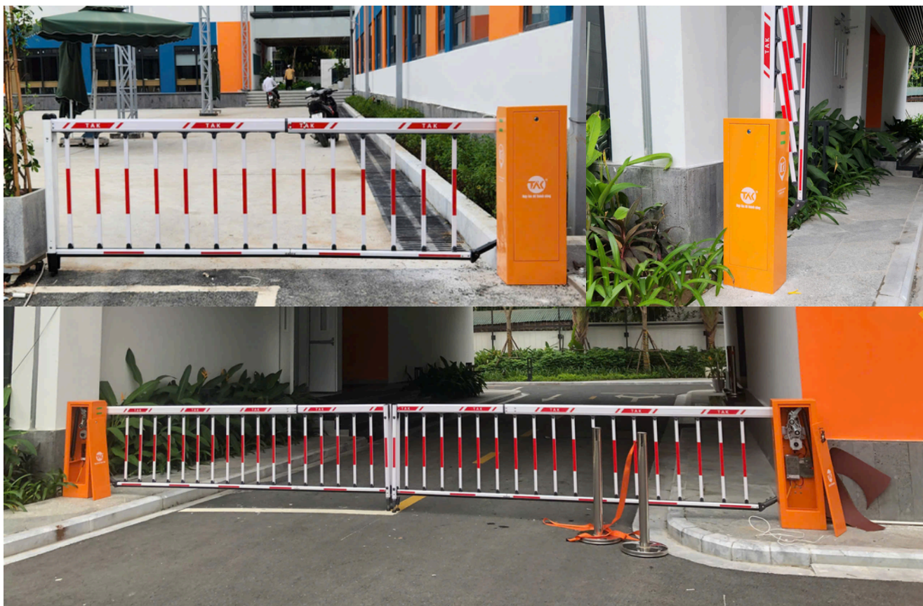
Hệ thống kiểm soát bãi đỗ xe Trường THPT Hòa Bình La Trobe Hà Nội
