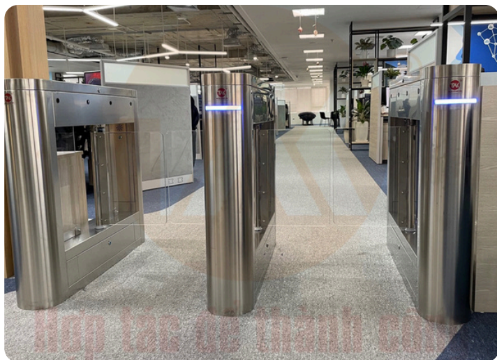
Hệ thống kiểm soát ra vào Tòa nhà Văn phòng Thăng Long Tower
