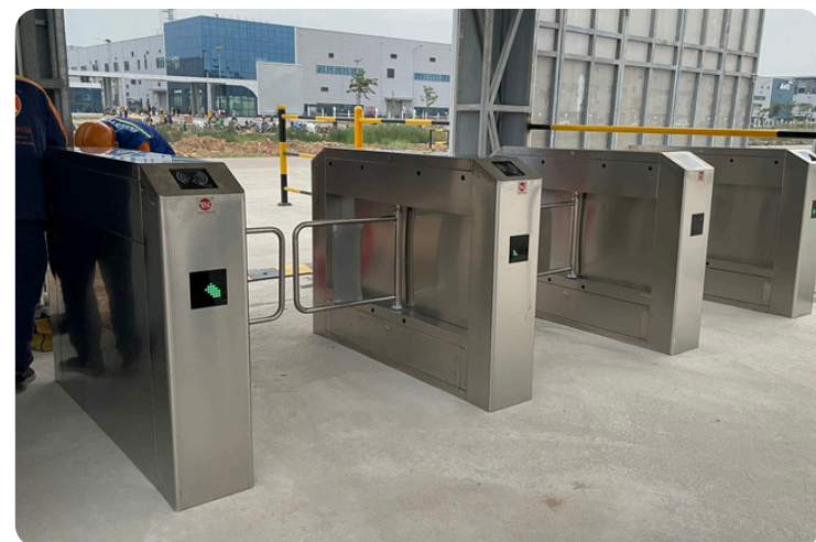
Hệ thống kiểm soát ra vào Nhà máy Autoliv – Quảng Ninh
