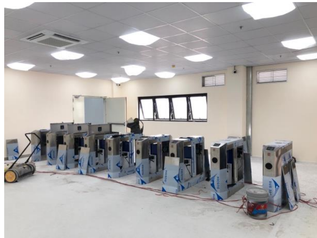
Nhà máy Welco Hải Dương Hệ thống kiểm soát ra vào
