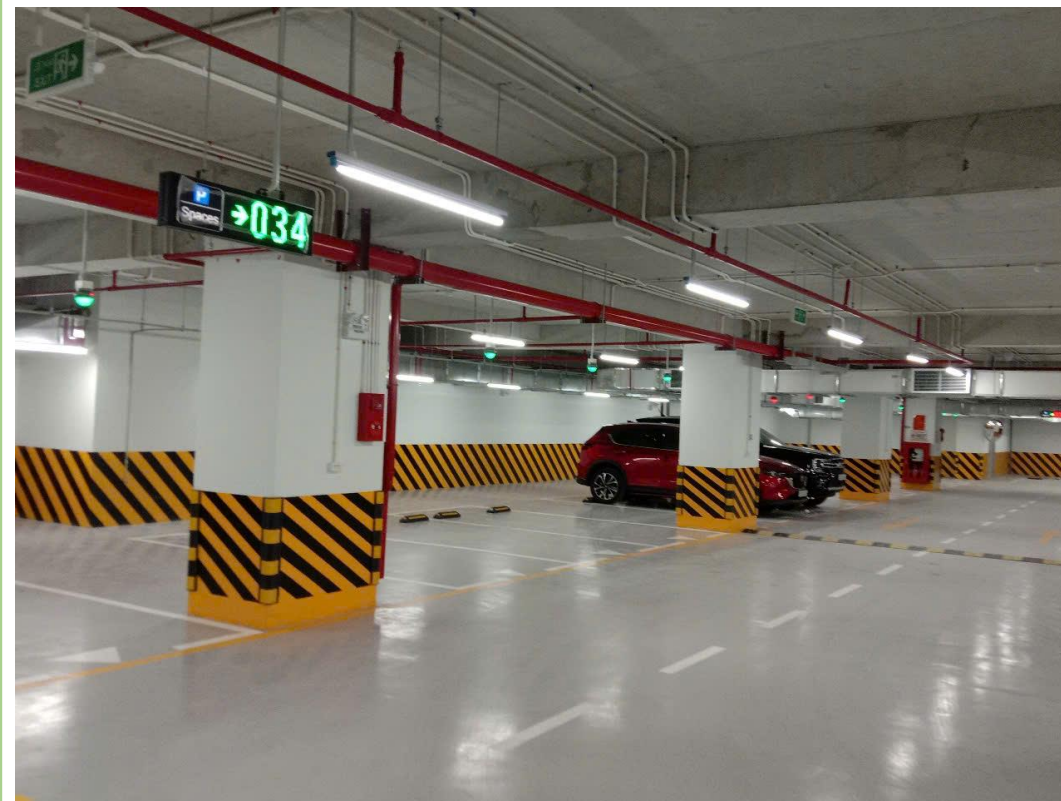
Cục An ninh điều tra – Bộ Công An Hệ thống kiểm soát phương tiện + báo chỗ trống tầng hầm
