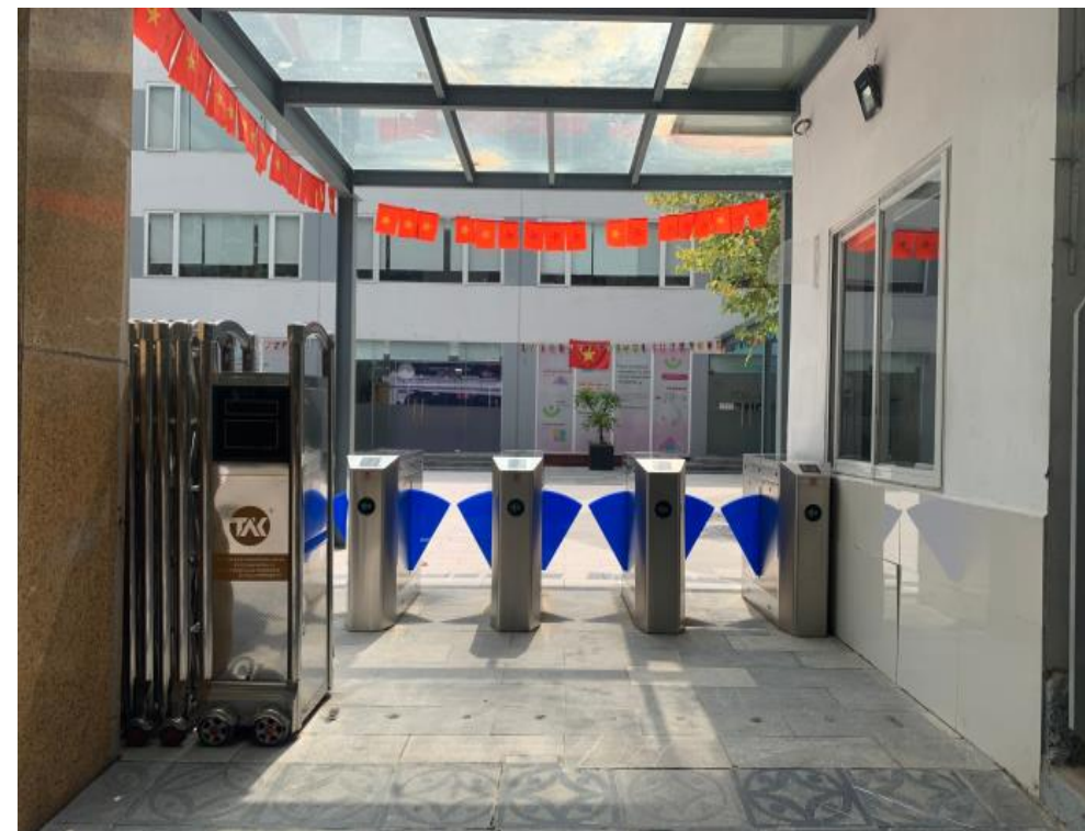
Trường Mầm Non Sakura Cổng xếp điện và Flap barie
